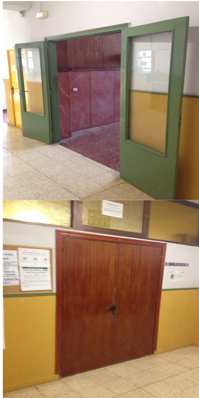
IMAGEN 5 y 6. Falta de compartimentación de escaleras y locales de riesgo especial
