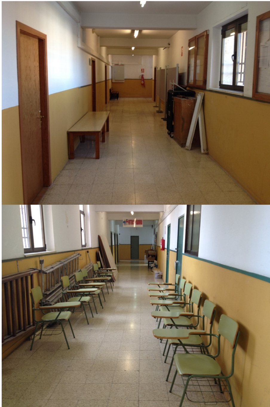
IMAGEN 7 y 8. Dificultad para visualizar las señalizaciones de evacuación y de equipos de lucha contra incendios
