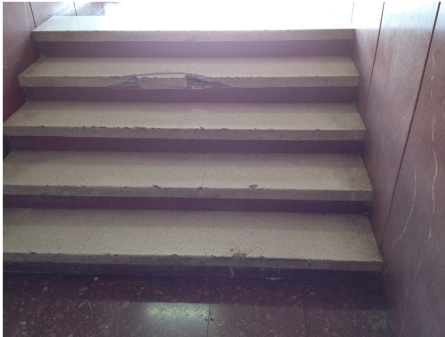
IMAGEN 9. Huellas rotas en la escalera.
