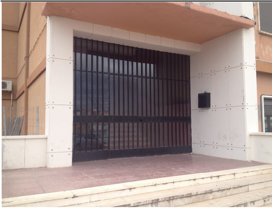
IMÁGEN 1 y 2. Accesos al edificio permanentemente cerrados
